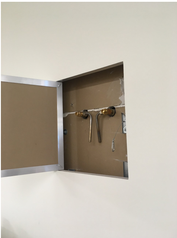
図1 廊下の壁内に設置された水道配管からの採水ポイント(ドイツ)
