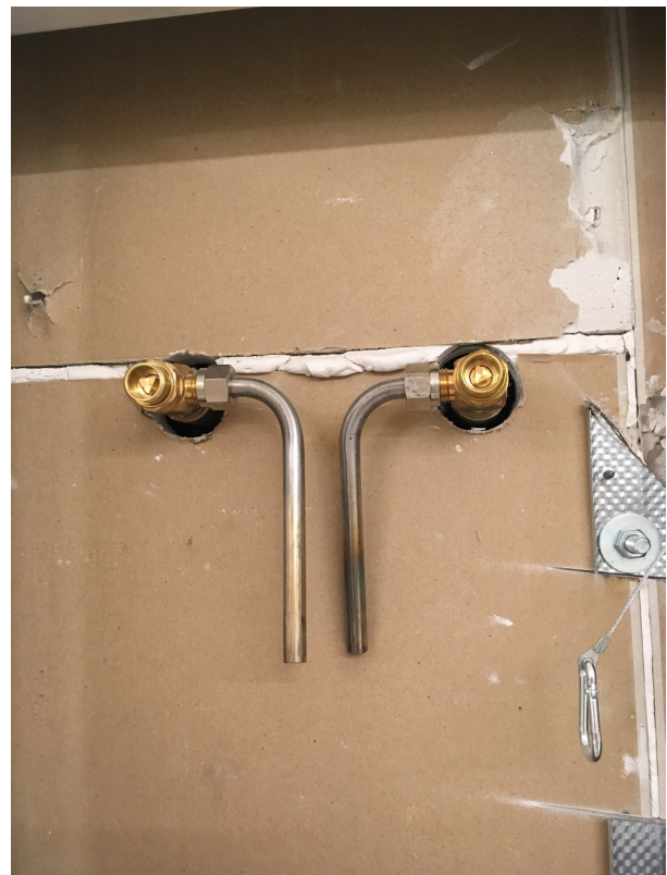
図2 廊下の壁内に設置された水道配管からの採水ポイントの拡大(ドイツ)
