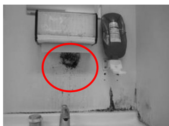
ペーパータオルホルダー 取り付け部の下に黒色の汚染 (一部クロスが剥がれている)
